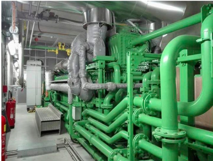
Le moteur de la centrale de cogénération sur l'exploitation de Christophe Rousse © Radio France - Morgane Heuclin-Reffait
